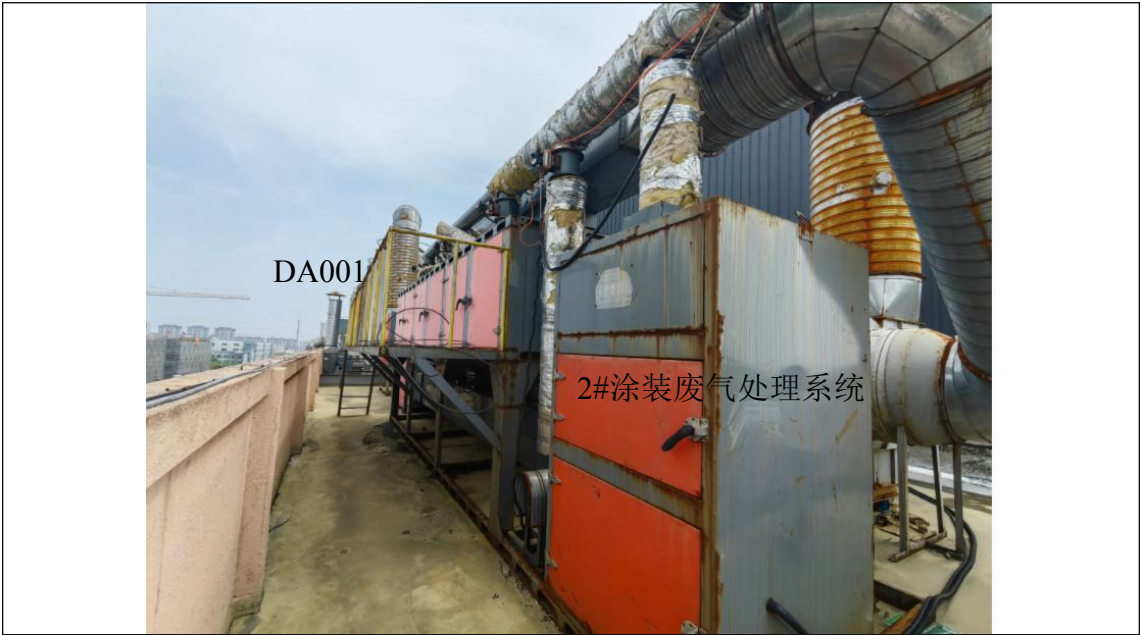
DA001（注塑吹塑废气）、2#涂装废气处理系统
