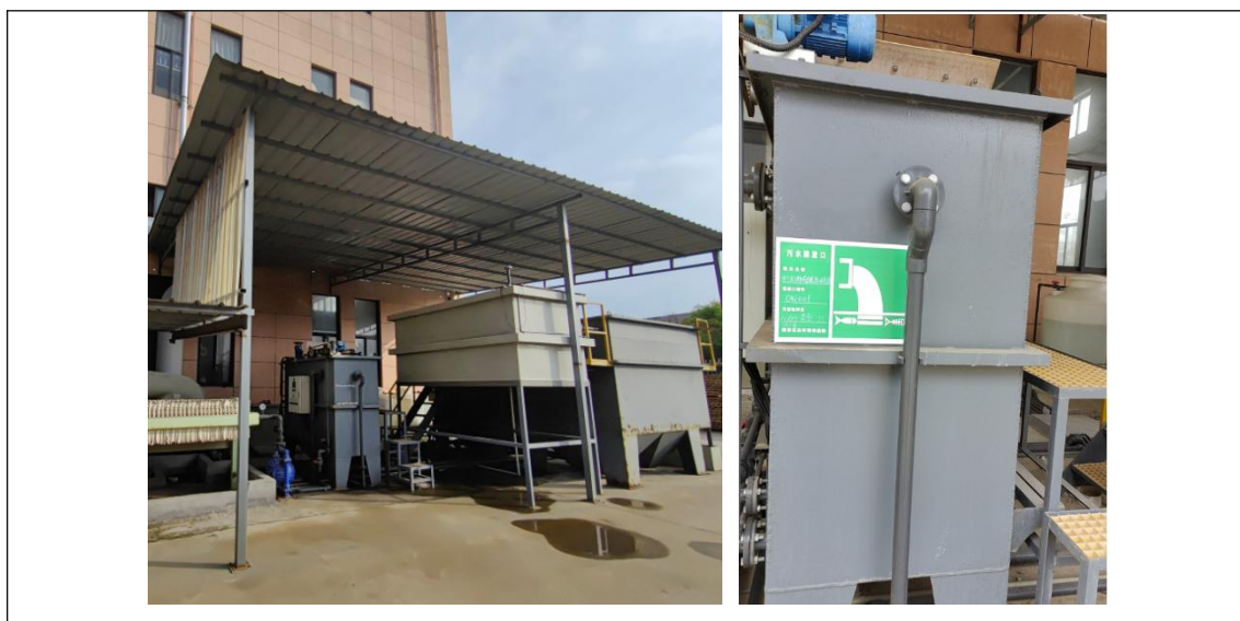
图 4-6 生产废水处理设备现场照片
