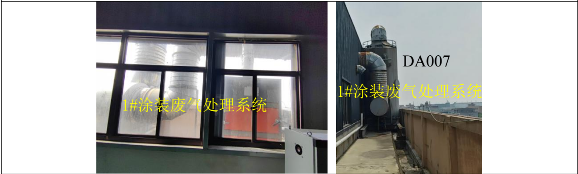
1#涂装废气处理系统、DA007
